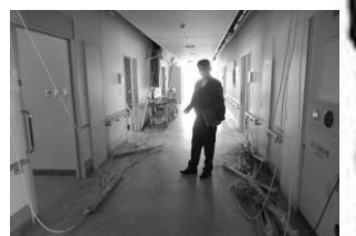
ケーブルがぶら下がったままの町立富来病院の2階病棟
